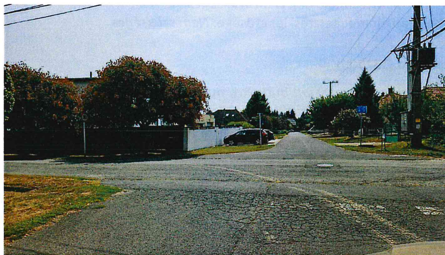
Dózsa utca -Seregélyes utcák kereszteződése, a mozaikos repedések a burkolat teherbírás problémájára utal
