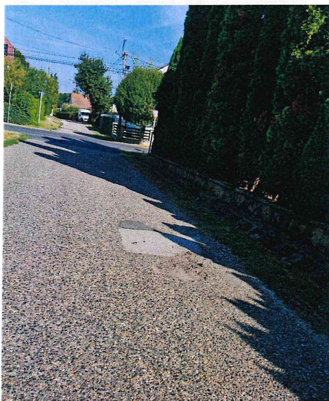
Hegyalja utcáról nyíló 840 hrsz.-ú utca, felületi kigyűrődés látható az útcsatlakozó előtt közvetlenül
