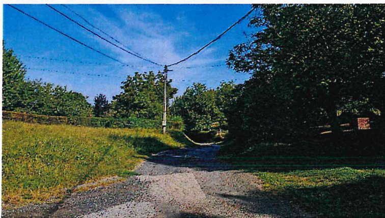
Kilátó utca – Arany János utca keresztezésben a burkolat mozaikos, deformált állapotú
