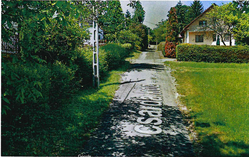
Csárda köz burkolata szétesett
