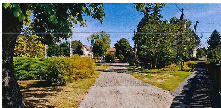
Mozaikos, deformált burkolat
