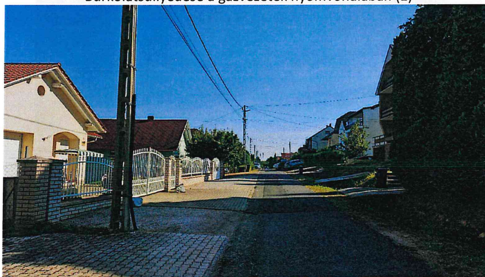
Burkolatsüllyedése a gázvezeték nyomvonalában (2)
