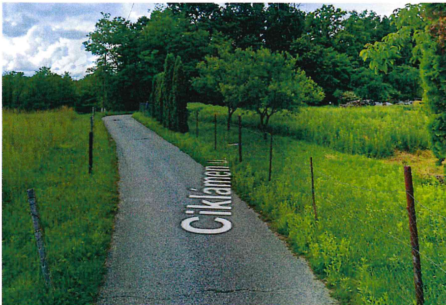
Ciklámen utcán látható burkolati reflexiós repedések
