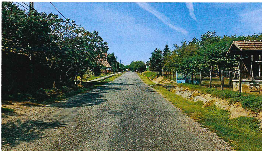
Dózsa utca burkolata kavicsaszfalt és felülete mozaikos szétesett és bomlott, fészkes
