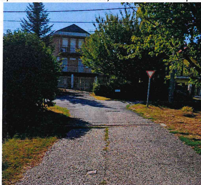
Gyöngyvirág sor – 760/1 hrsz.-ú út csatlakozása, a vízvezető rács környezetében burkolatsüllyedés tapasztalható
