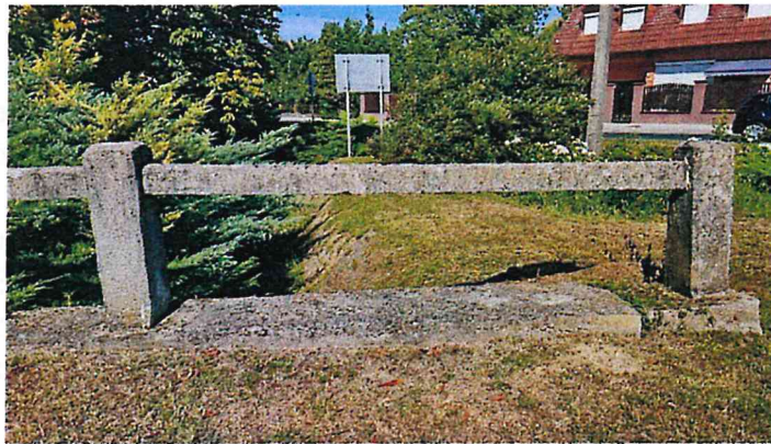
Kossuth út betonkorlát pótpadkán karbonátosodási folyamatok láthatók
