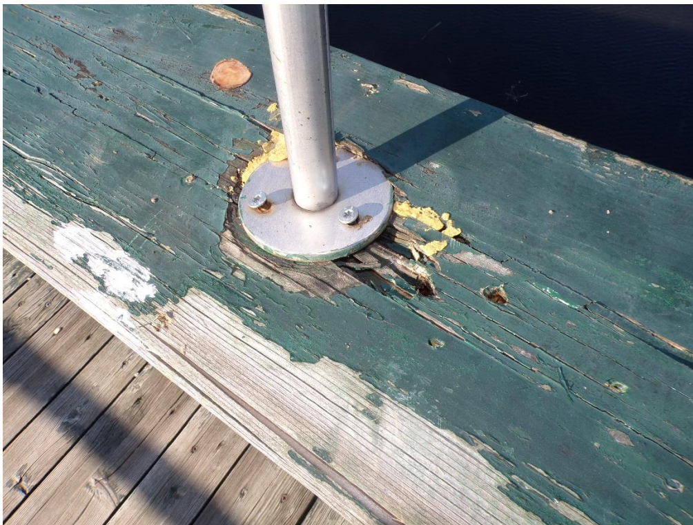
9. ábra: A szerkezet általános hibája: pangóvíz miatt kialakult korhadás a korált rögzítése mellett
