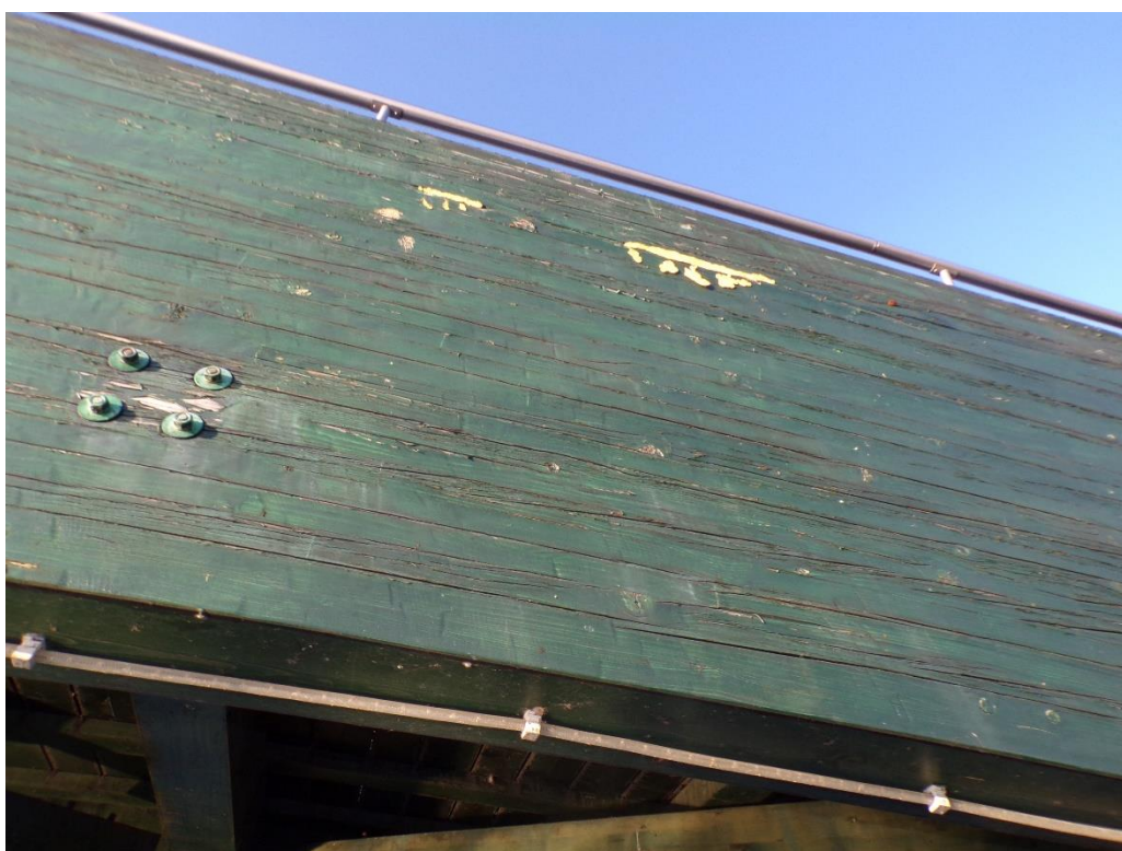
20. ábra: Az A tartó 2-3 közötti belső korhadásának forrása, utólag PUR habbal kitöltve 2
