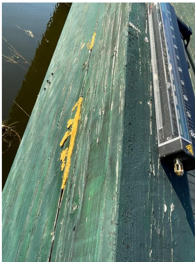
21. ábra: Az A tartó 2-3 közötti belső korhadásának forrása, utólag PUR habbal kitöltve 3
