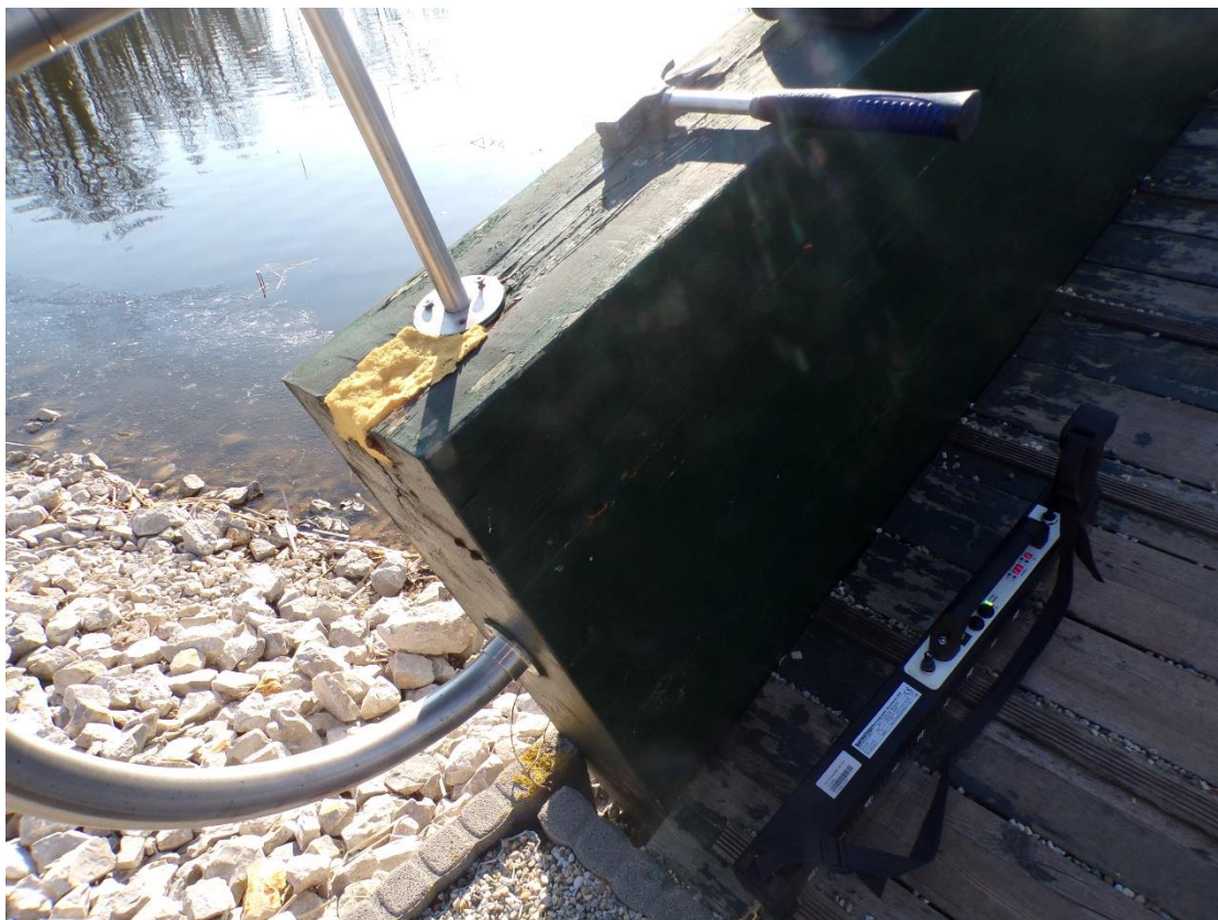
17. ábra: A tartó 1 közelében lévő korhadt, utólag PUR habbal kitöltött vége
