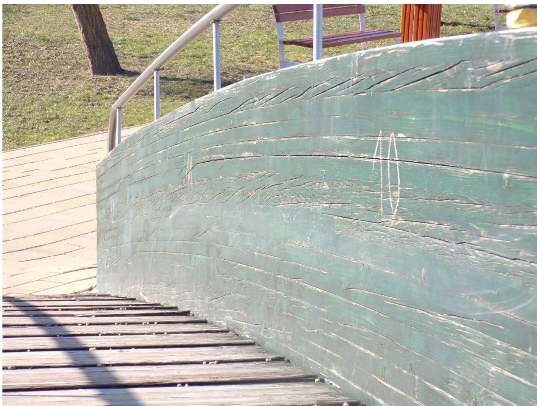
15. ábra: Lamella elválások, száradási repedések a B tartón
