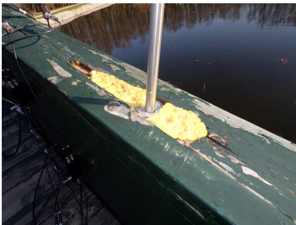
26. ábra: Korlát rögzítése beszakadt, utólagosan PUR habbal kitöltésre került
