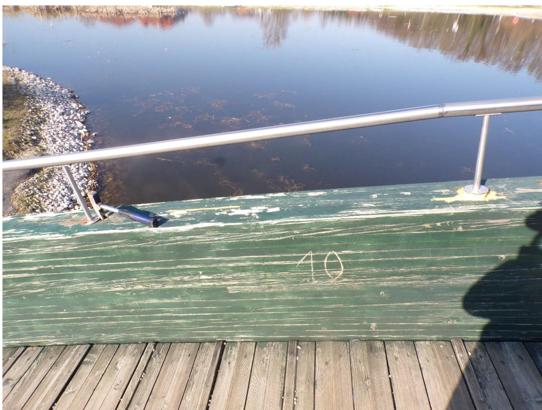
16. ábra: Korlát rögzítési pontoknál korhadt felső lamella, kopott felületkezelés a teljes paláston
