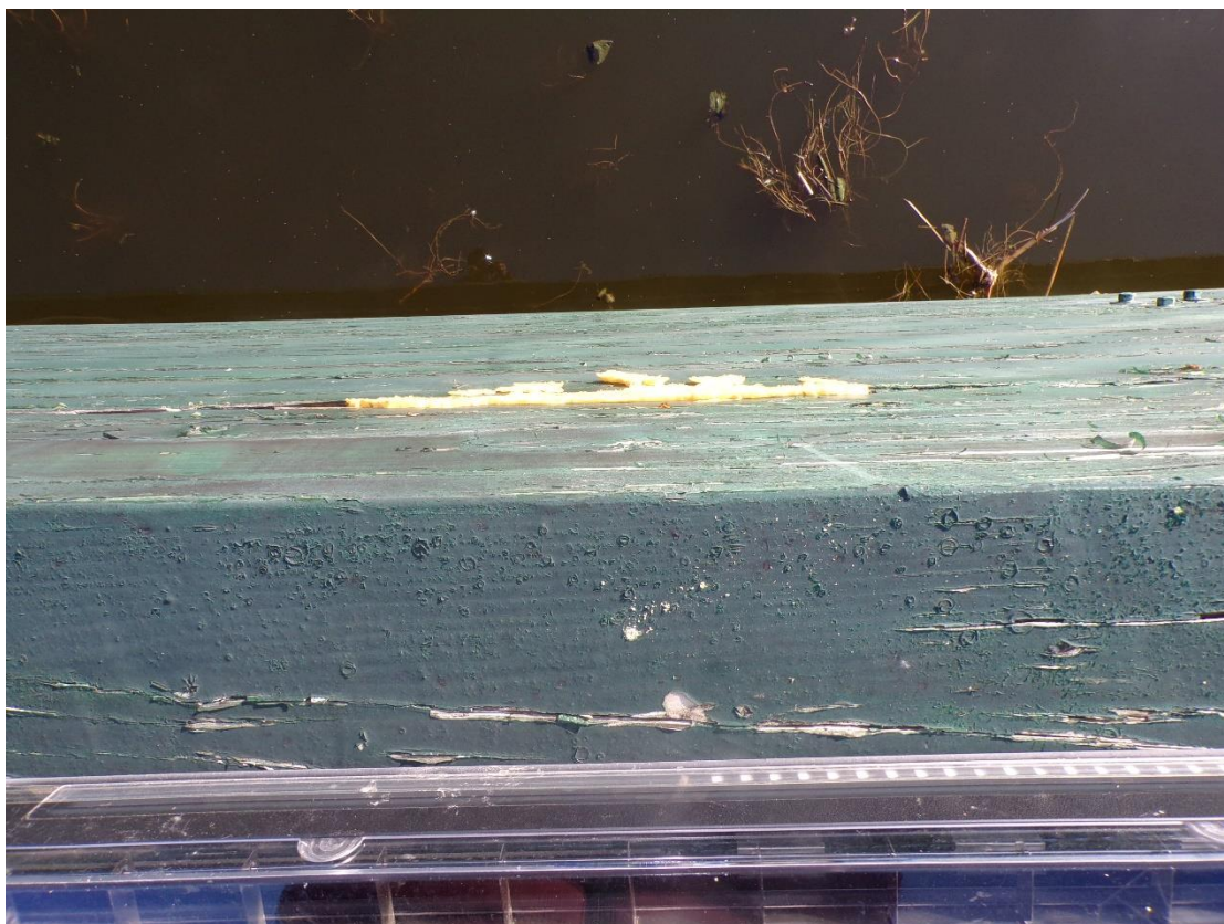
19. ábra: Az A tartó 2-3 közötti belső korhadásának forrása, utólag PUR habbal kitöltve 1
